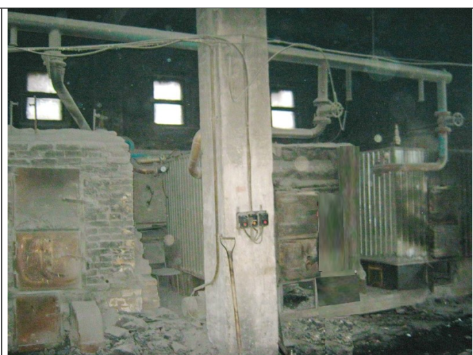
Рисунок 1.2.6 – Котлы в котельной
