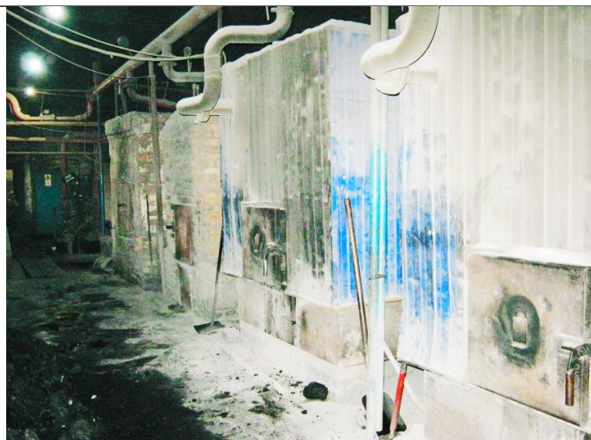
Рисунок 1.2.2 – Котлы в котельной
